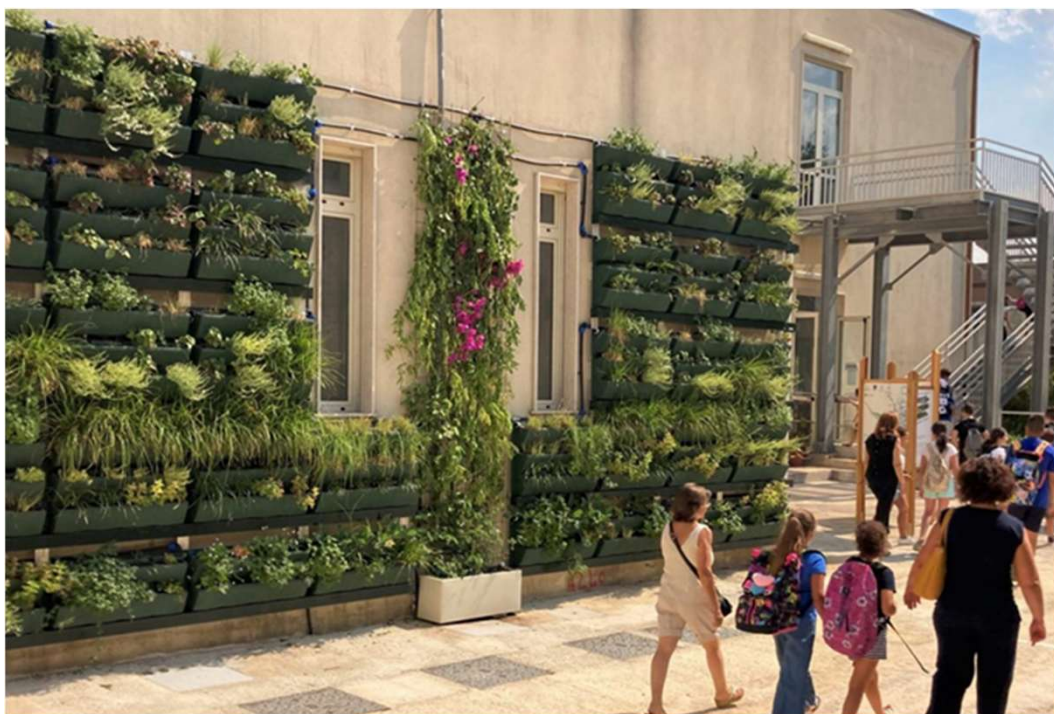
Parete verde di Ferla per il trattamento di acque grigie ed il riutilizzo per lo scarico dei bagni di una scuola
